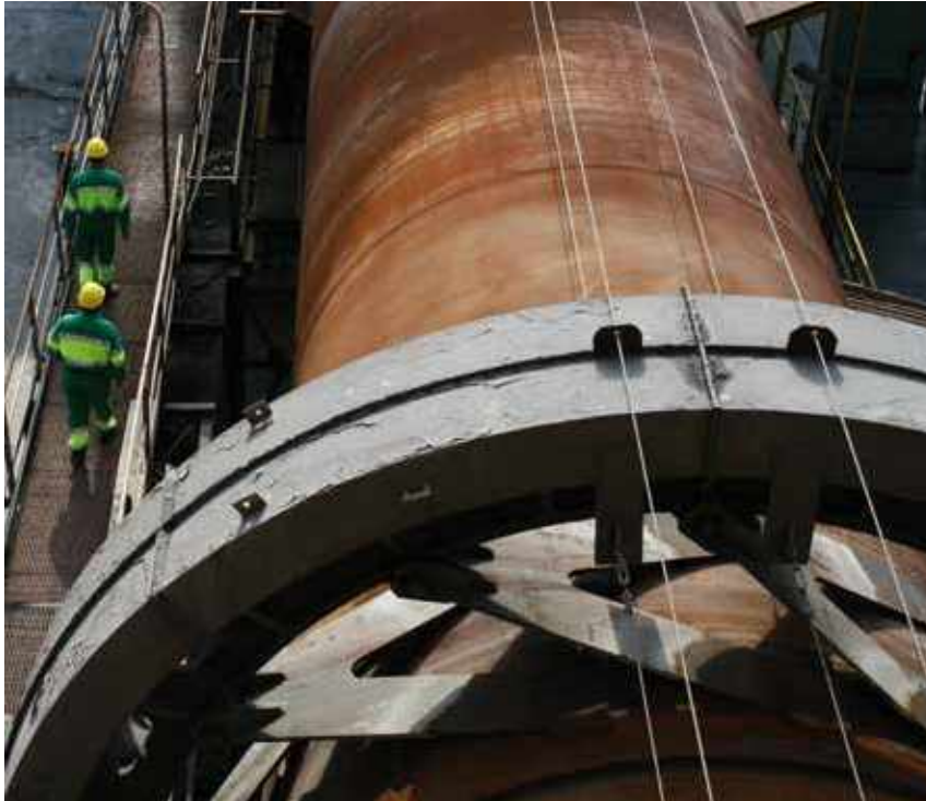
Περιστροφική κάμινος, η καρδιά ενός εργοστασίου τσιμέντου (εργοστάσιο Μηλακίου)
